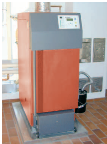
Typisch für den österreichischen und deutschen Markt - der Pelletszentralheizkessel
